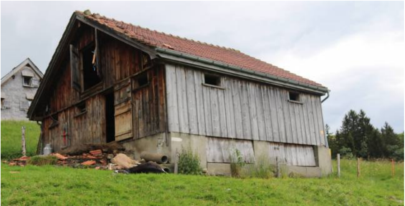
Beschädigter Weidestall an der Egglistrasse. (Bild: kai)
